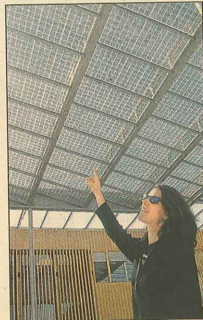
Glasüberdachung des Gemeindezentrums von Ludesch F.:Ertex
